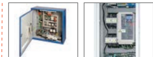
Quadro di manovra Impianto oleodinamico Quadro di manovra Impianto Mrl
